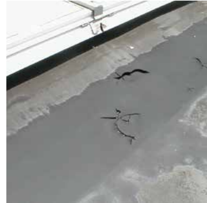
Materialschäden erfordern eine Dachsanierung
