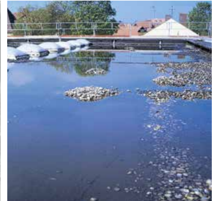
Stehendes Wasser auf einem Null-Grad-Dach
