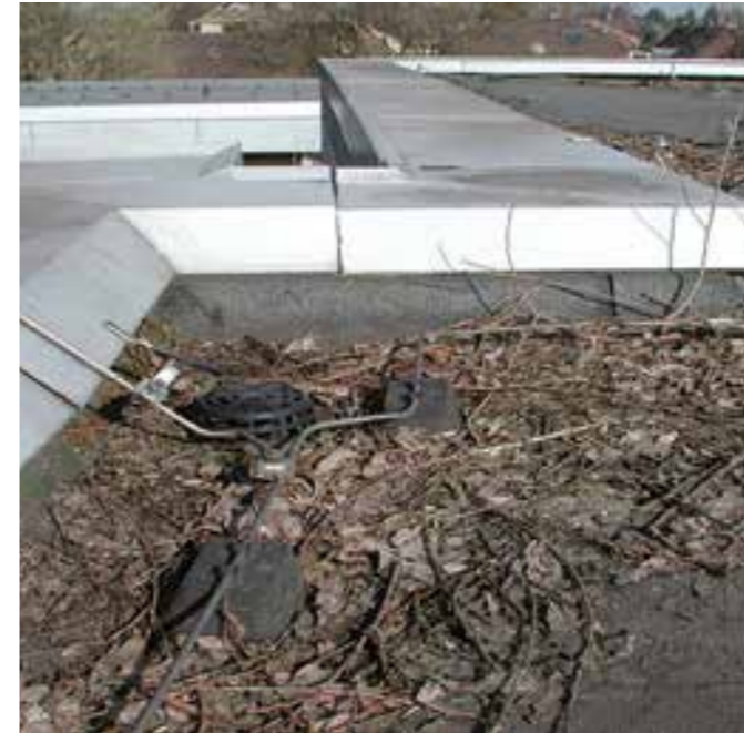
Regelmäßige fachgerechte Wartung verhindert Folgeschäden
